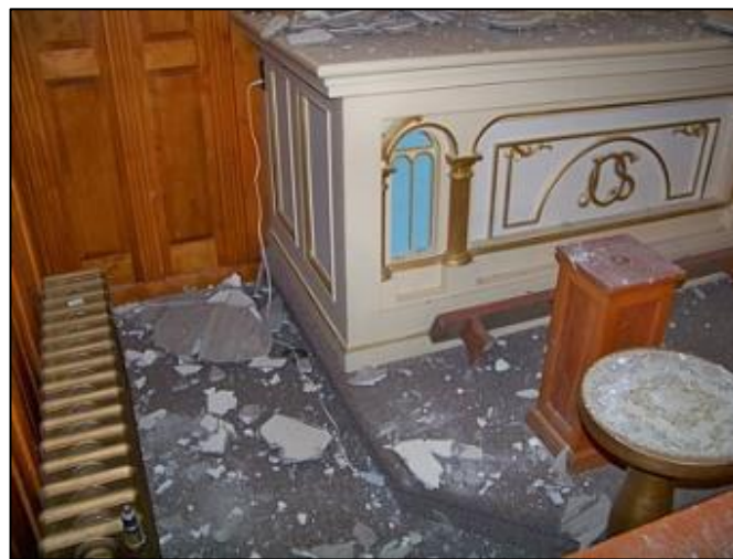
Chute d'une partie du recouvrement du plafond de l'église de Sainte-Françoise suite à des infiltrations d'eau. Photo : Yves-Marie Mélançon, 2014.
