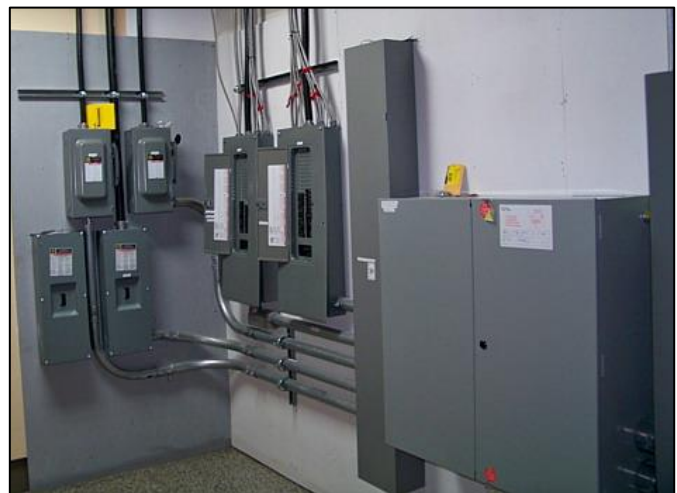
Nouvelle « salle des disjoncteurs » installée au sous-sol de l'aile nord-est dans un local attenant à la Pourvoirie d'autrefois et occupé jusqu'en 2019 par le photocopieur des Services diocésains. Photo : Yves-Marie Mélançon.
